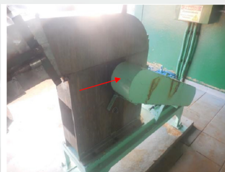
Figura 08: Proteção do acionamento do desintegrador (inadequado).
